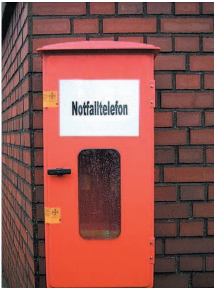
Abb. 12: Notfalltelefon am Havaristen.
