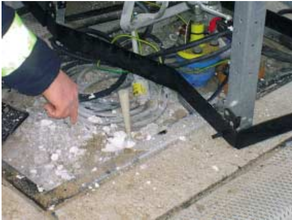
Mit Kunststoffstopfen abgedichtete Rücklaufleitung.
