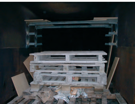
Befeuierungsstelle der Wärmegewöhnungsanlage.
