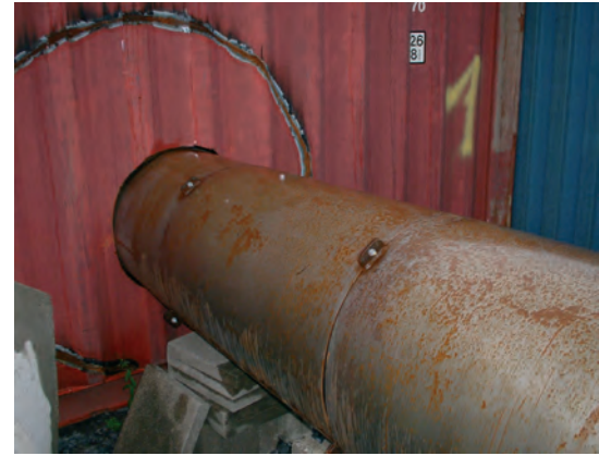
Verbindungsrohre zwischen den beiden Brandcontainern.
