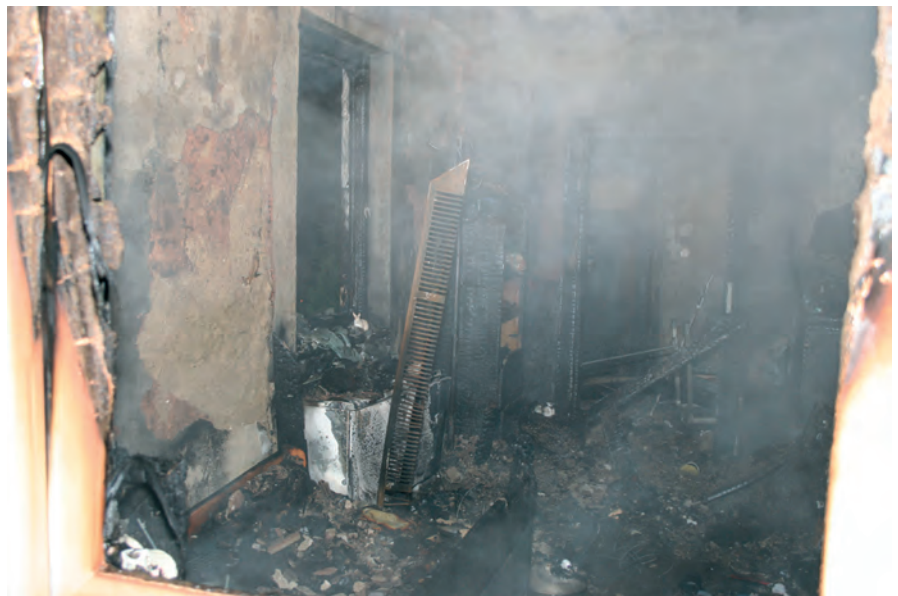
Innenansicht zerstörtes Kinderzimmer
