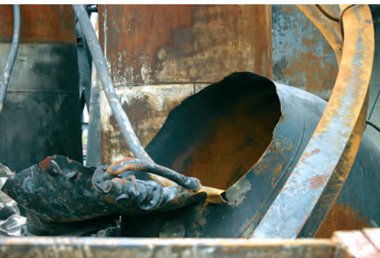
Einer der Großtanks riss unterhalb des Doms auf.
