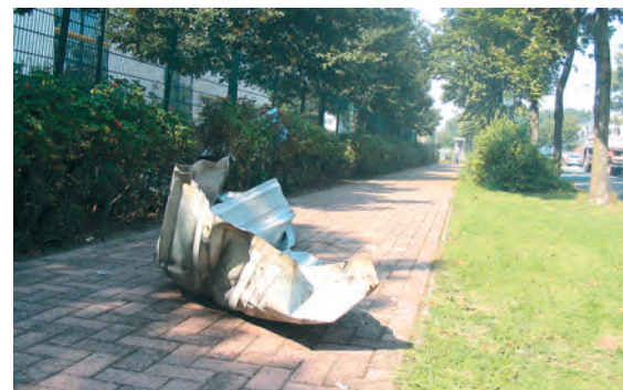
Teile der Fassadenverkleidung flogen 100 Meter weit. Nur durch großes Glück wurde dabei niemand verletzt.
