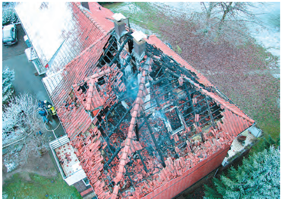
Ansicht des betroffenen Gebäudeteils aus der Drehleiter
