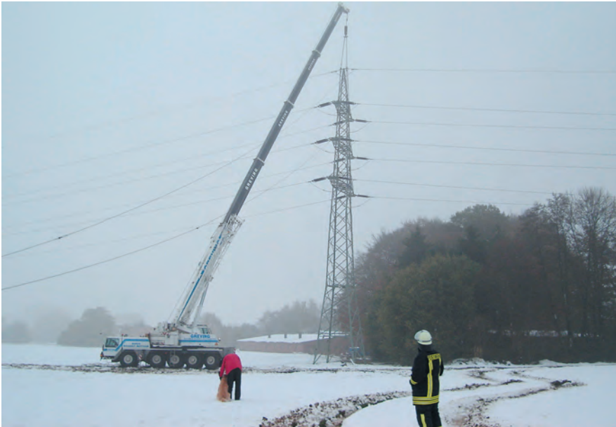
Bild 7: schadhafter Leitungsmast in Horstmar-Leer wird mit Automobilkran gesichert (Quelle: Jan Wenking, Horstmar)
