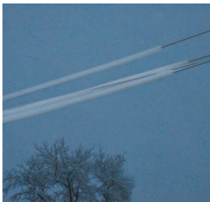
Freileitung mit Eispanzer (Quelle: Jan Wenking, Horstmar)
