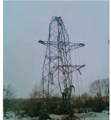
Leitungsmast unter Eislast zusammengebrochen (Quelle: Bernhard Duesmann, Steinfurt)
