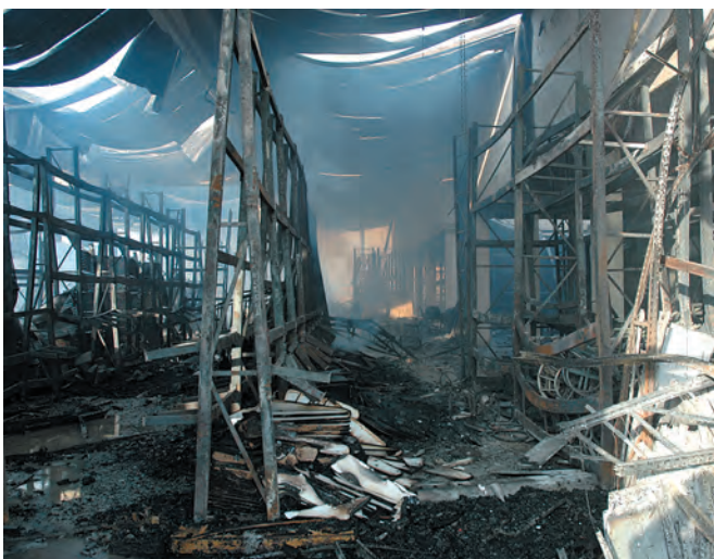
Die totale Zerstörung im Inneren des Objektes. Einzelne Brände konnten erst am Tag nach dem Großbrand gelöscht werden.
