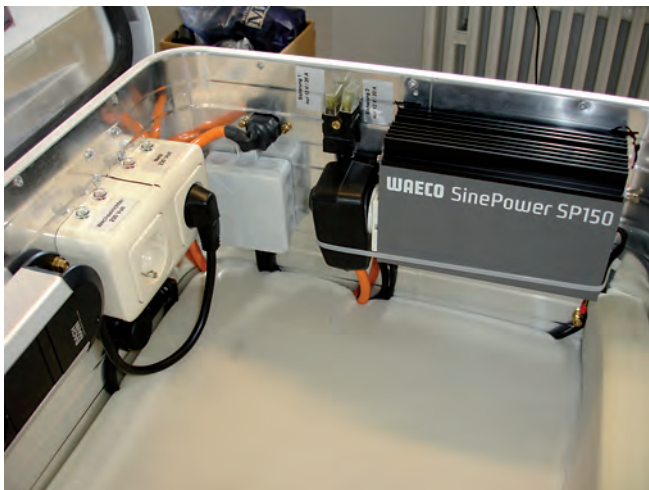
Spannungswandler und mit LED-Betriebsleuchten ausgestattete Steckdosen für die Mehrfachsteckdose zur Verteilung der Betriebsspannung 230V.
