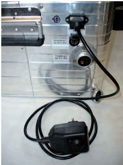
Einspeisung mit 230V-Wechselstrom, gesichert durch einen FI-Schutzschalter.
