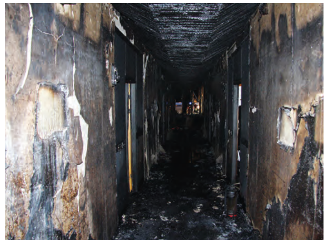
Zerstörter Flur im 1 OG.
