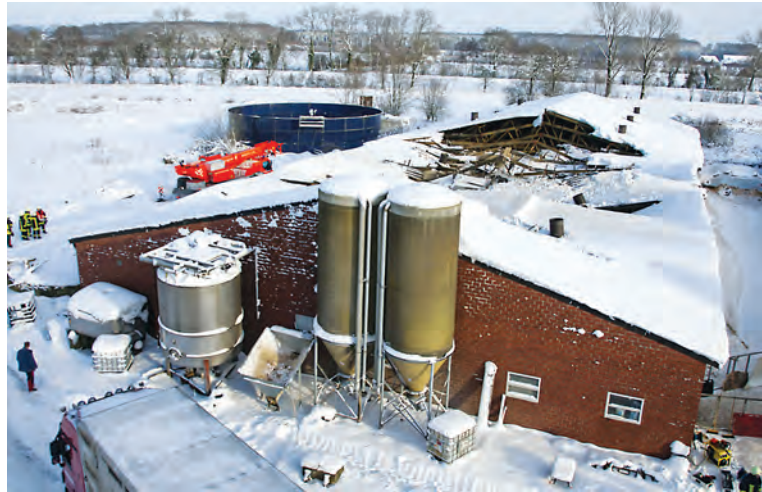
Eingestürztes Dach eines Schweinestalls in Dülmen-Buldern.
