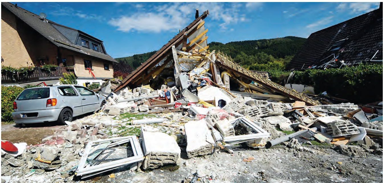
Komplett zerstörtes Einfamilienhaus
