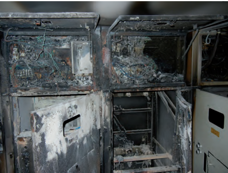
Die Elektroverteilungen wurden vom Brand teilweise vollständig zerstört.
